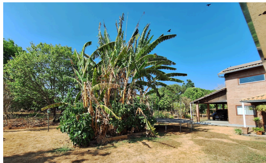
Fig. 120. Bacia de Evapotranspiração (fossa de bananeira) residencial - Ecovila Santa Branca, Terezópolis, GO Fonte: foto do autor (2025)
