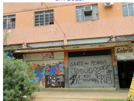
Figura 34: Depredação da Rua do Lazer em 2023.
