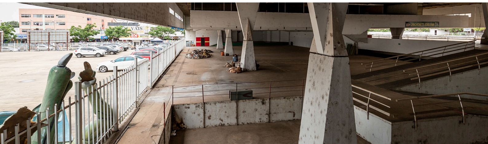
Figura 12 - Deterioração do complexo do Jockey Clube de Goiás. Fonte: Portifólio de Eurípedes Afonso da Silva Neto.
