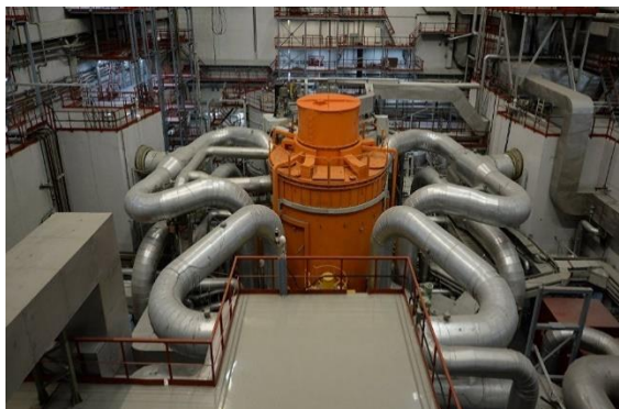
Figura 1.14: Vista interna de uma usina nuclear do tipo FBR, destacando o gerador principal (em laranja) e o complexo sistema de tubulações que conduzem vapor das turbinas, essenciais para a conversão de energia térmica em elétrica.
