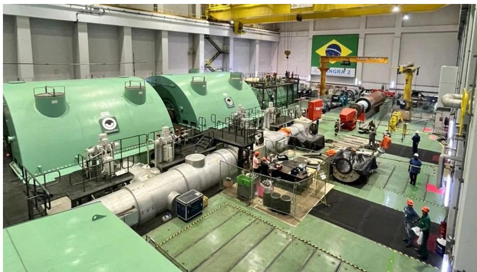
Figura 1.8: Área onde estão as turbinas e o gerador de Angra 2.
