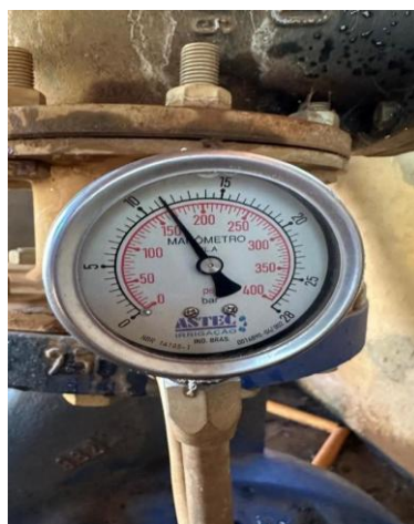
Figura 5: Pressão da bomba aberta.
