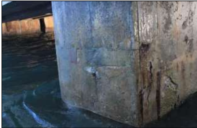
Figura 19 - Pilar sofrendo o processo de erosão. Fonte: Latorre (2002, apud Trindade, 2015).
