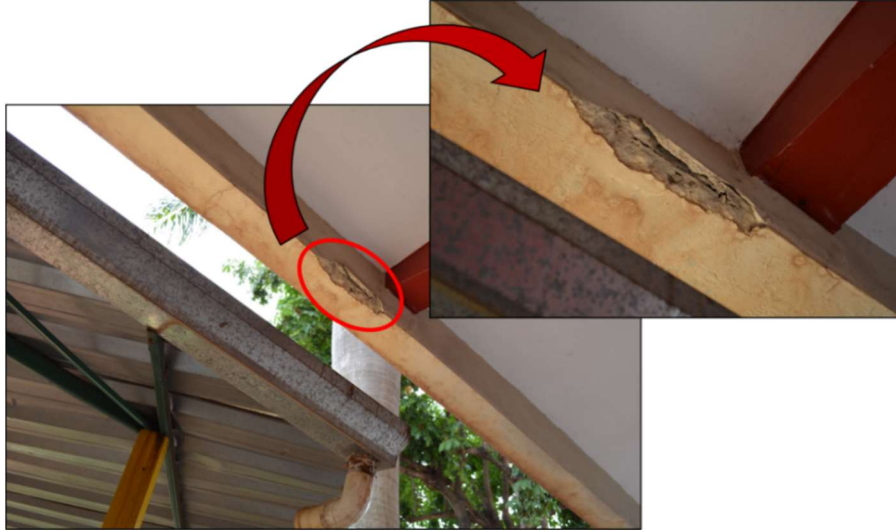
Figura 47 - Armadura exposta em viga. Fonte: Autor próprio (2020).
