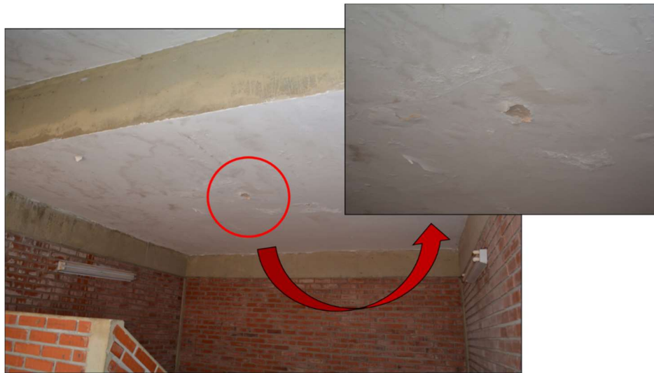
Figura 45 - Manchas e deslocamento em laje sob reservatório superior. Fonte: Autor próprio (2020).
