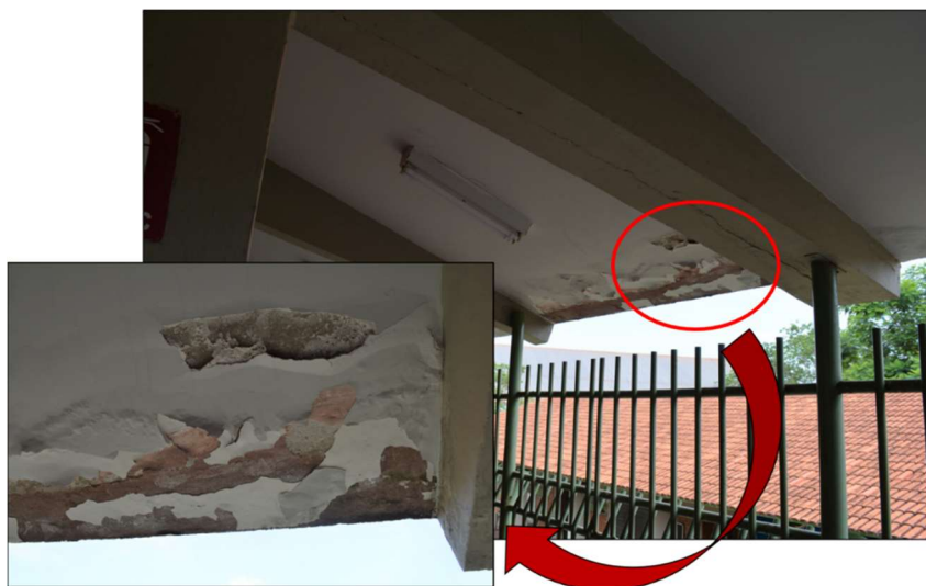
Figura 62 - Deslocamento da camada de gesso corrido e tinta de laje externa. Fonte: Autor próprio (2020).
