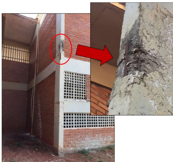
Figura 66 - Pilar de canto do reservatório superior com armadura exposta. Fonte: Autor próprio (2020).
