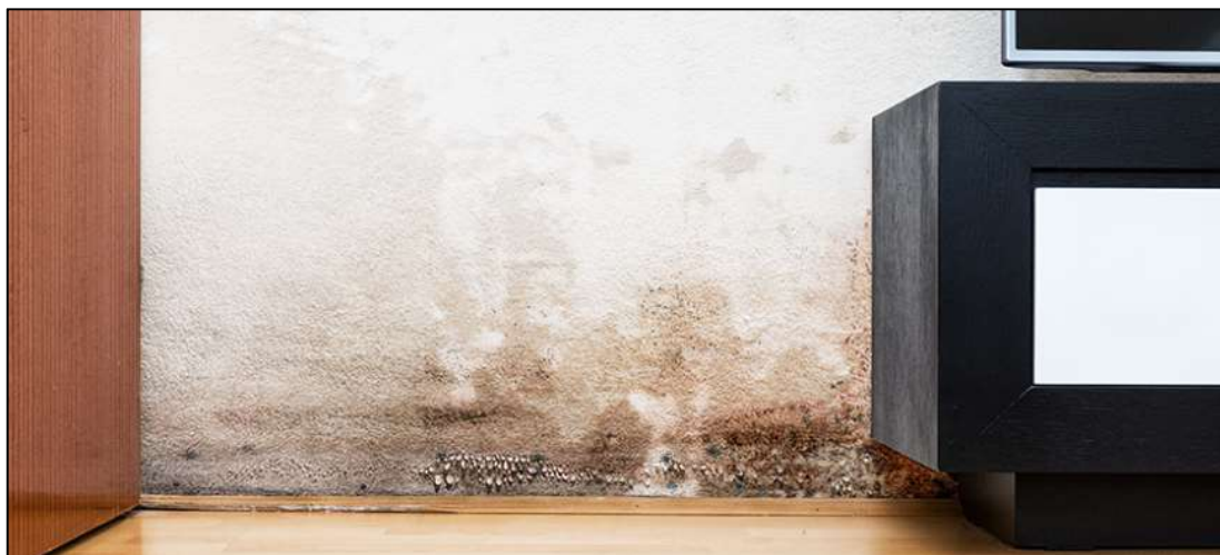
Figura 12 – Bolor (mofo) na parede. Fonte: WEG – Blog Tomadas & Interruptores (2018).
