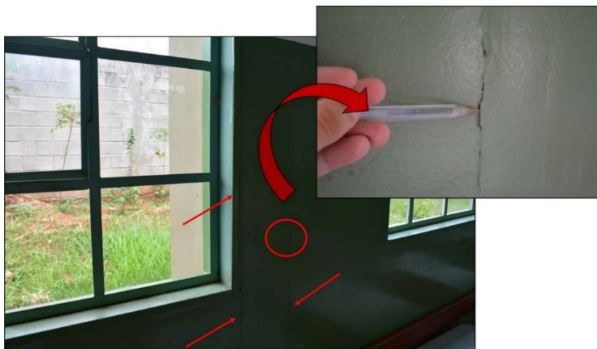
Figura 39 – Trinca na interface alvenaria/pilar. Fonte: Autor próprio (2020).
