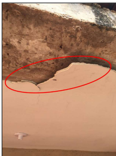
Figura 71 - Deslocamento de gesso corrido de laje externa. Fonte: Autor próprio (2020).
