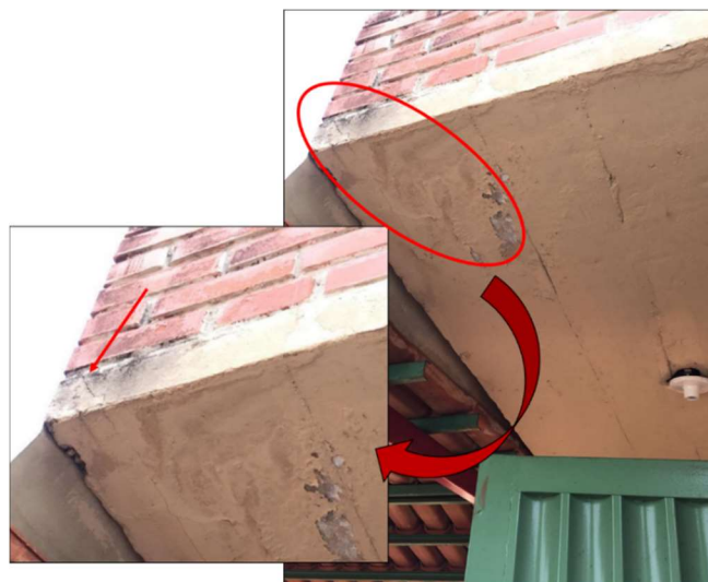
Figura 67 - Laje com infiltração e fissuras. Fonte: Autor próprio (2020).
