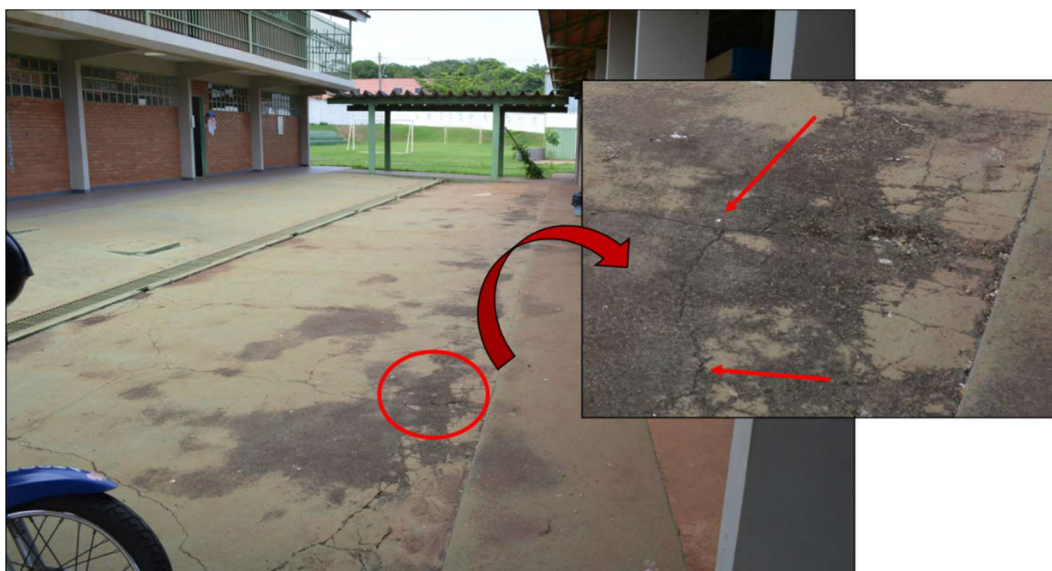
Figura 59 - Rachadura, mancha de bolor e deterioração física do pavimento do pátio. Fonte: Autor próprio (2020).
