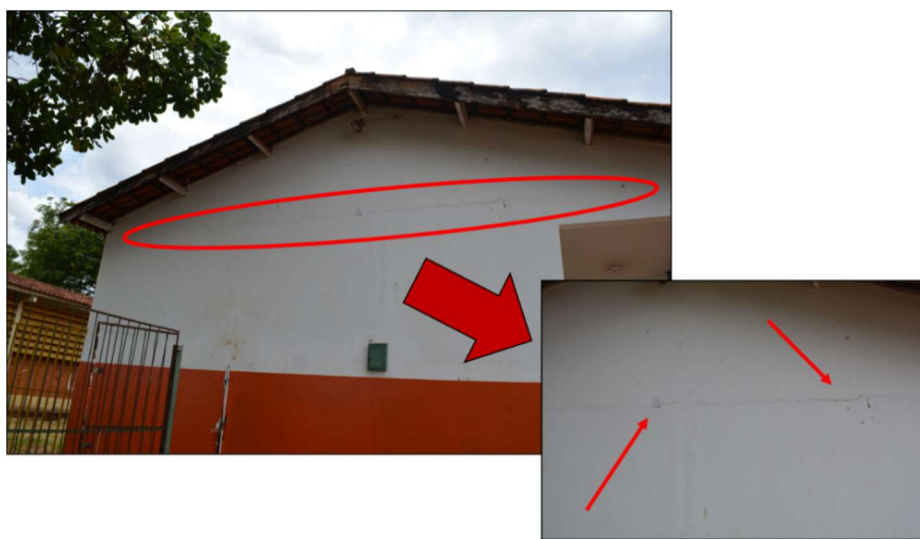
Figura 51 – Rachadura na interface alvenaria/viga em parede externa. Fonte: Autor próprio (2020).
