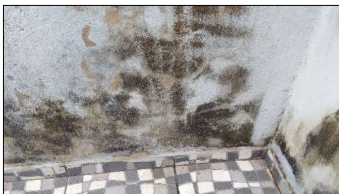
Figura 10 - Mancha ocasionada por infiltração de água da chuva. Fonte: Fórum da construção (2015).
