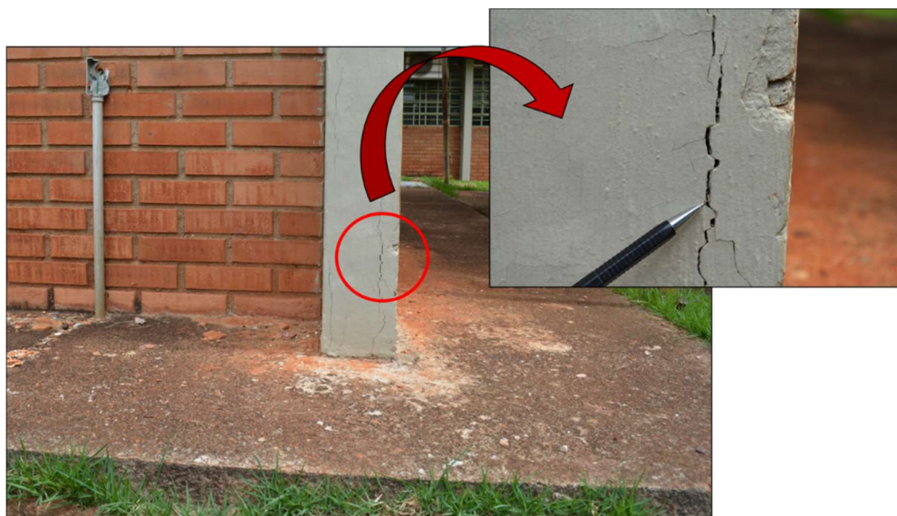
Figura 58 - Rachadura na parte inferior do pilar de extremidade. Fonte: Autor próprio (2020).
