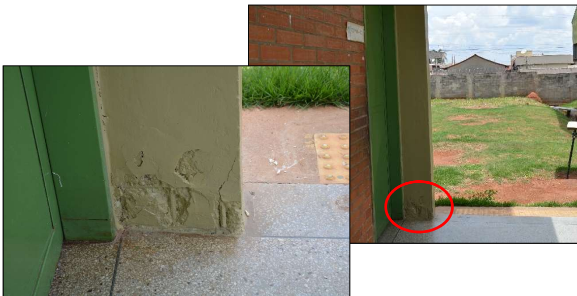
Figura 37 – Armadura exposta na parte inferior do pilar de extremidade. Fonte: Autor próprio (2020).
