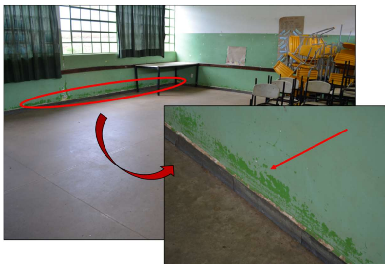
Figura 61 – Deslocamento da camada de tinta no roda-pé das salas de aula. Fonte: Autor próprio (2020).
