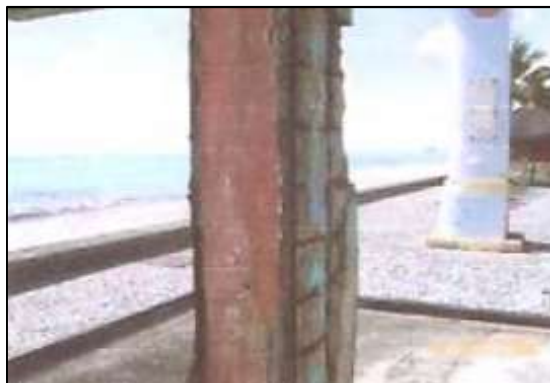
Figura 24 - Chuveirão localizado na orla de Boa Viagem em avançado grau de corrosão. Fonte: Mota et. al (2009, apud Mota et. al , 2020).
