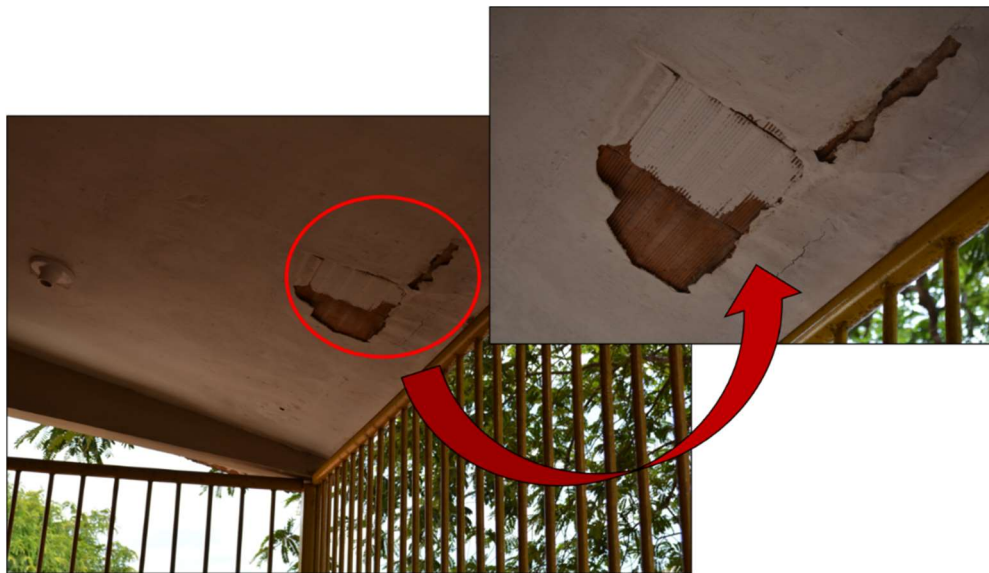
Figura 53 - Forro de gesso deslocando da laje e deixando exposto blocos cerâmicos que compõem a laje. Fonte: Autor próprio (2020).
