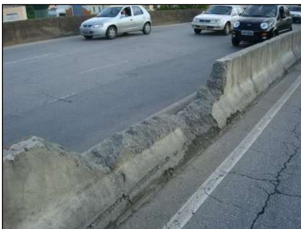
Figura 17 - Deterioração do concreto por causas mecânicas. Fonte: Santos (2012).
