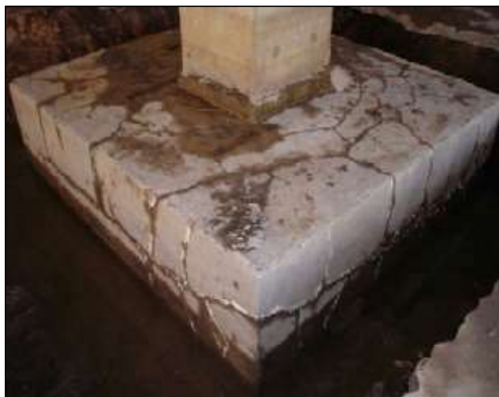
Figura 23 - Fissuração em blocos de fundação afetados pelo RAA. Fonte: Salles et. al. (2003, apud Mizumoto, 2009).
