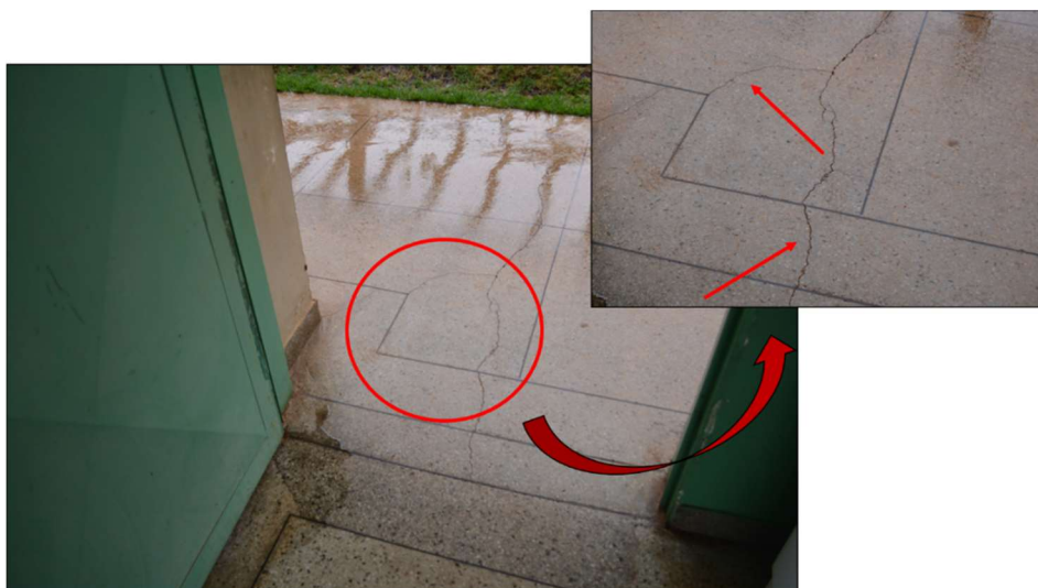
Figura 42 - Trinca em pavimento. Fonte: Autor próprio (2020).
