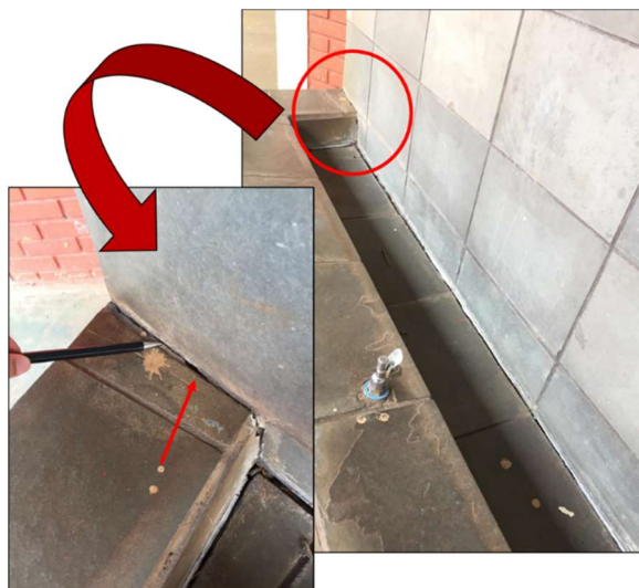
Figura 72 – Deterioração de junta do revestimento em bebedouro. Fonte: Autor próprio (2020).
