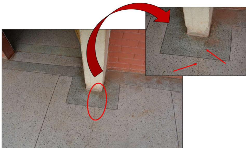
Figura 50 – Trinca em pavimento partindo da interface pilar/pavimentação. Fonte: Elaborado pelo autor. Fonte: Autor próprio (2020).
