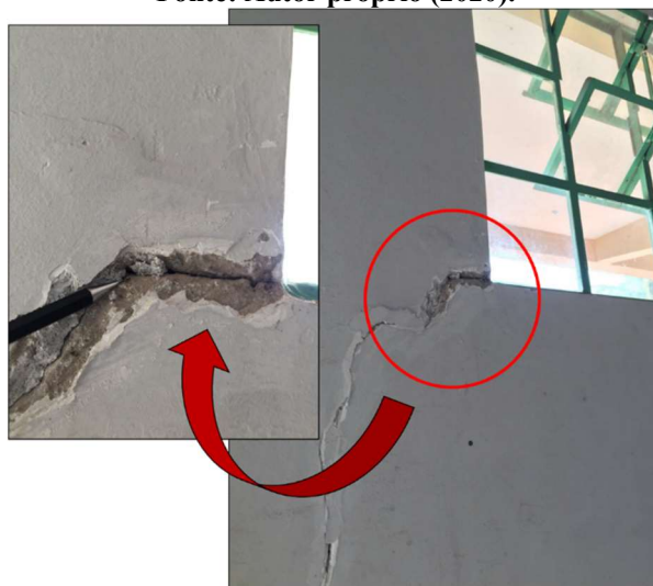
Figura 70 - Rachadura originada a partir do canto inferior da abertura (vão) de uma esquadria (janela). Fonte: Autor próprio (2020).
