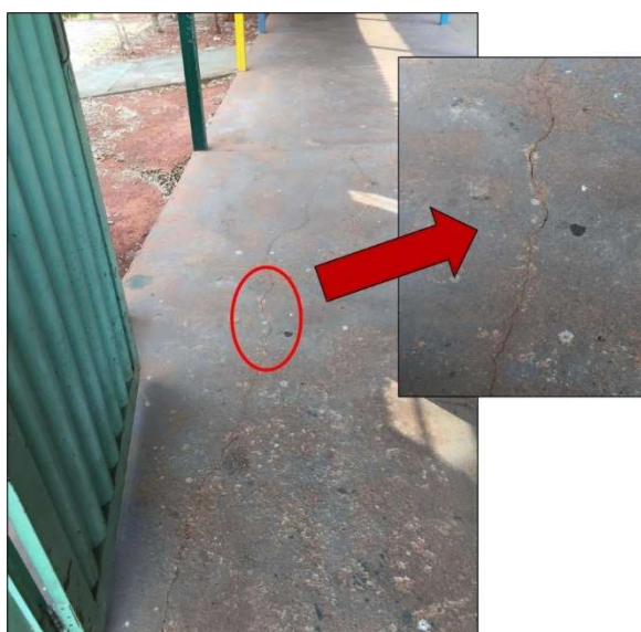
Figura 69 - Fissura em pavimento de concreto. Fonte: Autor próprio (2020).
