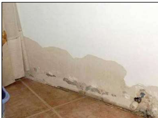
Figura 9 - Manchas por capilaridade. Fonte: Fórum da construção (2015).
