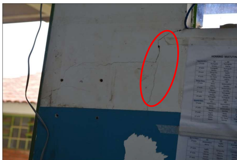
Figura 60 - Rachadura na extremidade da esquadria. Fonte: Autor próprio (2020).
