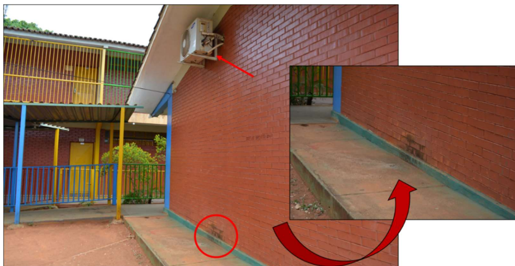
Figura 52 – Mancha no rodapé da parede externa devido a umidade oriunda do dreno do ar-condicionado. Fonte: Autor próprio (2020).
