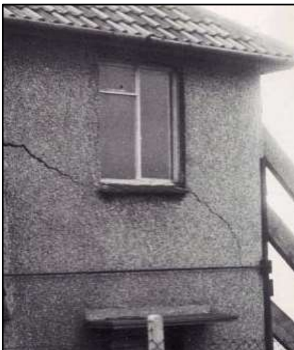
Figura 8 - Rachaduras inclinadas causadas por recalque das fundações (esquerda) e fissura horizontal nas juntas de argamassa causadas por reações químicas. Fonte: Elbridge (1982, apud Magalhães, 2004).
