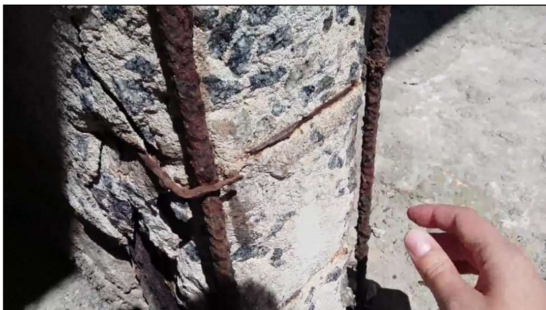
Figura 16 - Elemento estrutural com produtos da corrosão. Fonte: Site Tecnosil (2017).
