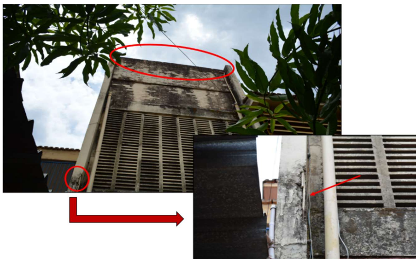
Figura 48 - Manchas e bolor na parede de concreto do reservatório superior e armadura do pilar que o sustenta exposta. Fonte: Autor próprio (2020).
