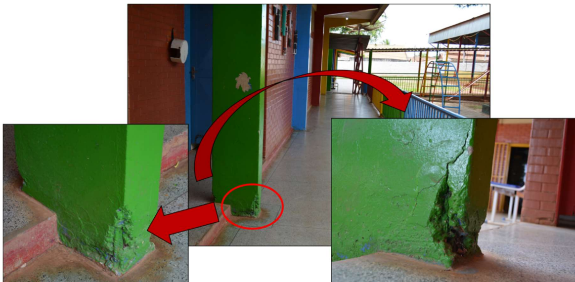
Figura 49 - Armadura exposta na parte inferior do pilar. Fonte: Autor próprio (2020).
