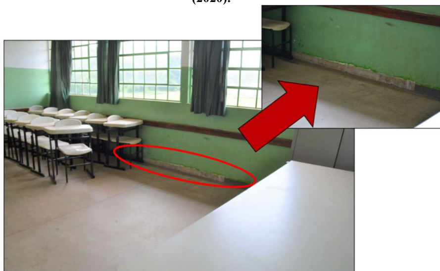
Figura 63 – Deslocamento de revestimento cerâmico do rodapé das salas de aula. Fonte: Autor próprio (2020).
