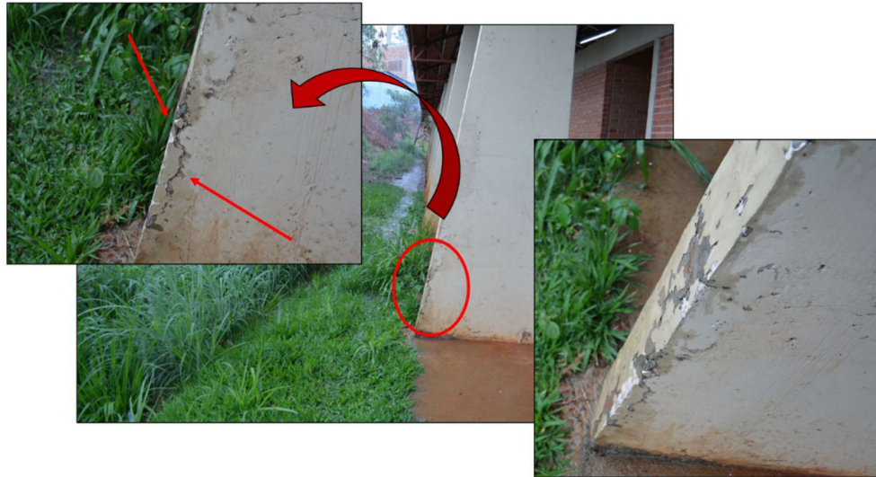
Figura 41 - Trinca e deslocamento da pintura em pilar de extremidade. Fonte: Autor próprio (2020).
