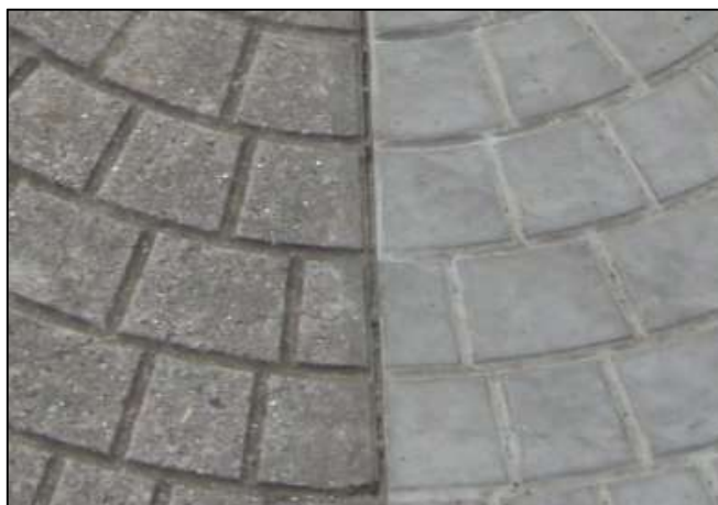
Figura 18 - Desgaste causado por abrasão. Fonte: Domus telhas e revestimento de concreto (2010).
