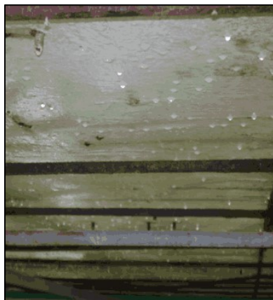
Figura 11 - Condensação em ambiente úmido. Fonte: CACE Engenharia (2014).
