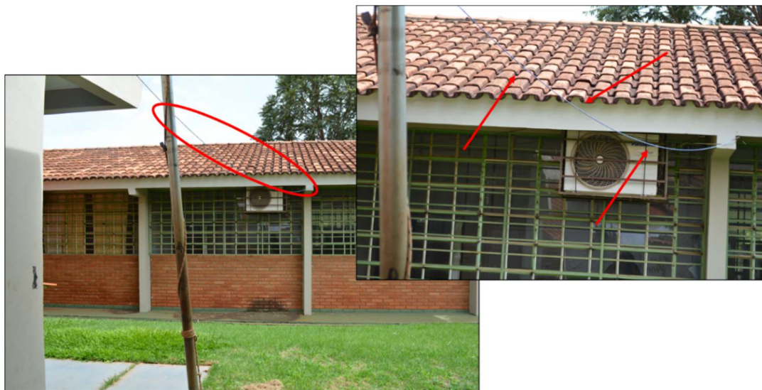
Figura 64 - Condutor elétrico exposto a 1,40m de altura, em desconformidade com as normas vigentes de instalações elétricas. Fonte: Autor próprio (2020).
