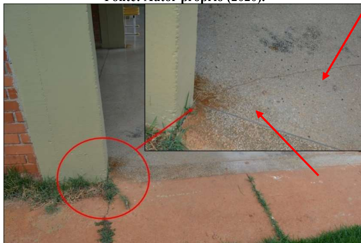
Figura 38 – Fissura em pavimento partindo da interface pilar/pavimentação. Fonte: Autor próprio (2020).
