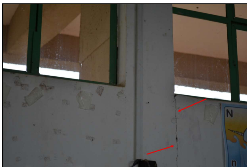
Figura 44 - Rachadura na interface pilar/alvenaria. Fonte: Autor próprio (2020).
