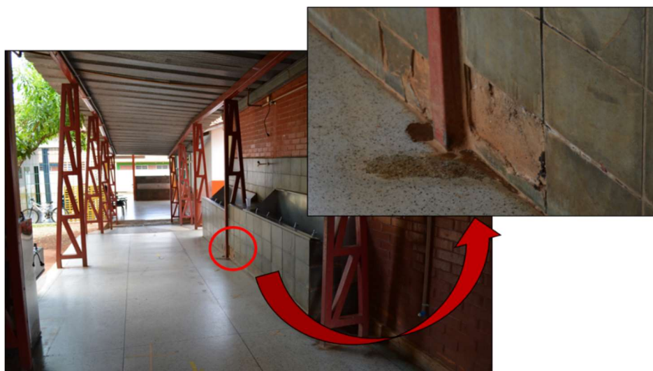
Figura 54 - Deslocamento de revestimento nas proximidades do bebedouro. Fonte: Autor próprio (2020).
