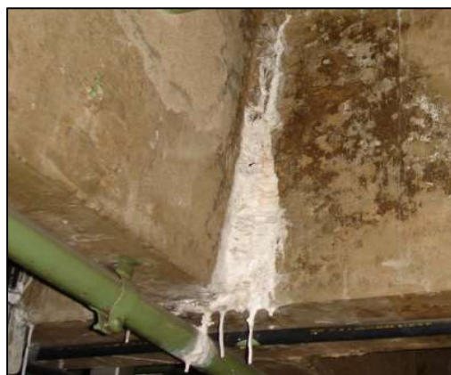
Figura 14 - Eflorescência em encontro de vigas em garagem. Fonte: Souza (2008).
