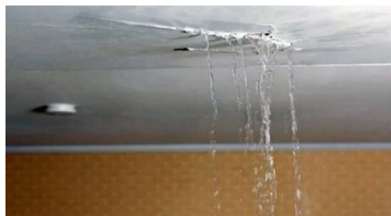
Figura 4: Efeitos da umidade em lajes de cobertura. Fonte: Macreengenharia, (2020).
