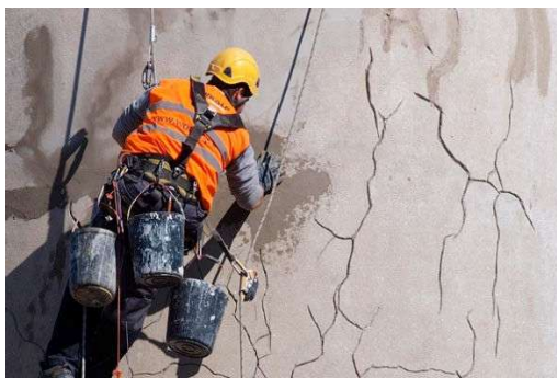
Figura 6: Fissura Mapeada. Fonte: Edifica consultoria, (2022).
