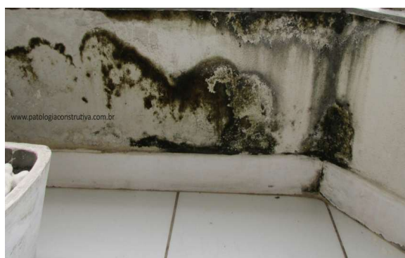
Figura 2: Efeitos da umidade ascendente. Fonte: Patologia da construção, (2020).
