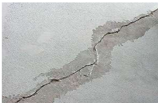
Figura 5: Fissura Geométrica. Fonte: Núcleo do conhecimento, (2023).
