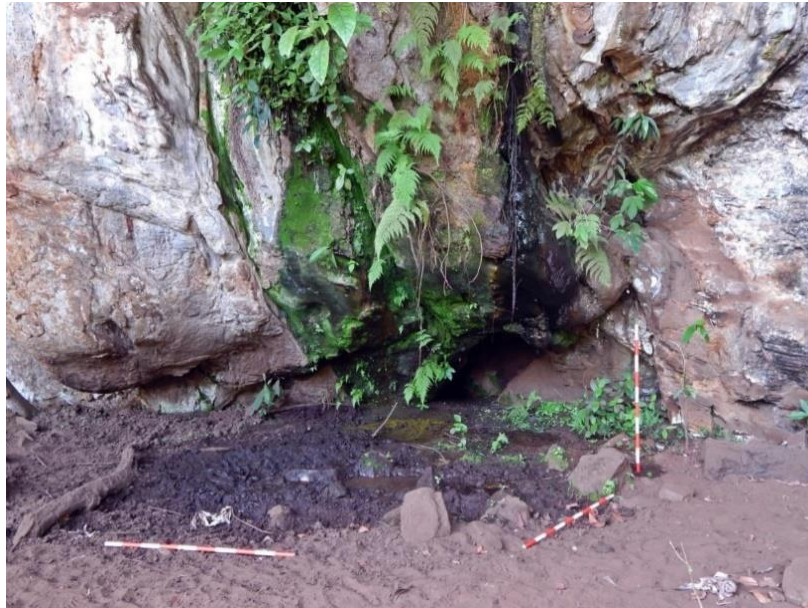
Figura 26. Detalhe da percolação de água nas fraturas da rocha, umidificando a parede e propiciando o desenvolvimento de vegetação rasteira. Setor A, GO-JA-02. Fonte: Acervo Projeto Serranópolis.
