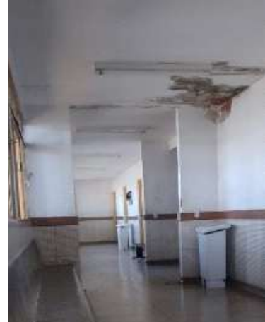
(Cais Nova Era, Corredor de espera com infiltração) imagem autoral - registrado em 08-03-2020
