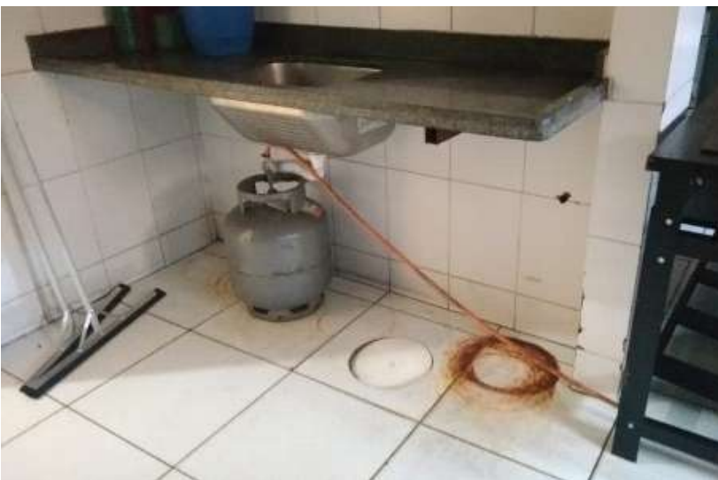
(Cais Nova Era, botijão de gás na área interna da cozinha e instalação irregular) imagem autoral, registrado em 08-03-2020
