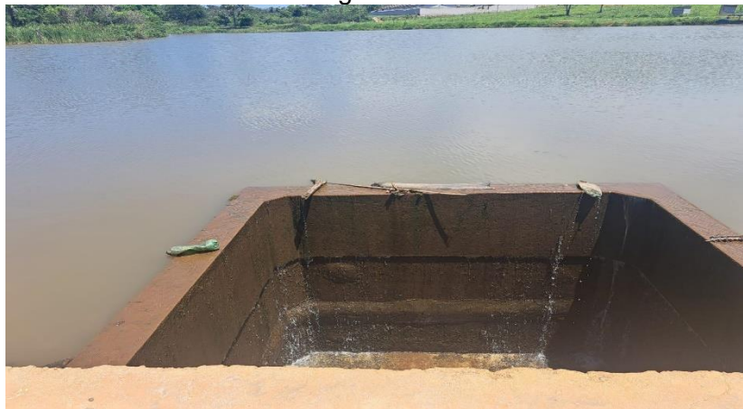
Figura 26 – Estrutura de concreto para saída da água, a fim de escoar a água e evitar alagamentos
