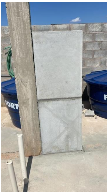
Figura 11 - Falta de intertravamento
