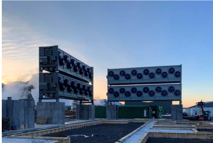
Figura 3: Usina DAC localizada na Islândia
