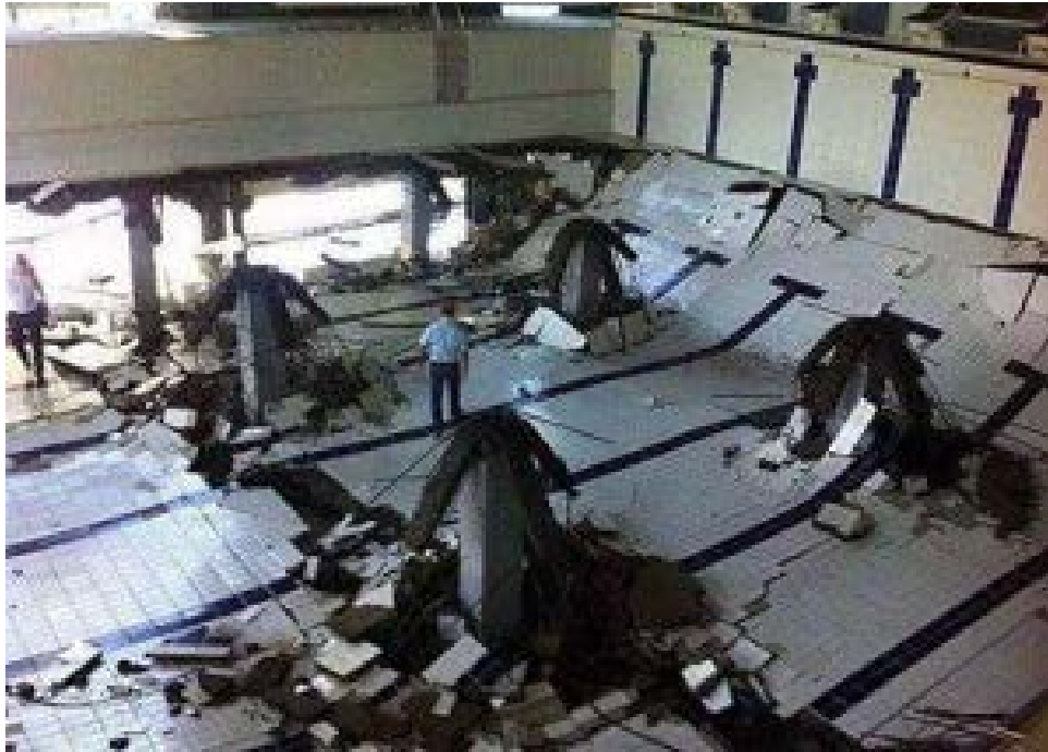
Figura 2 - Efeito de punção em laje de fundo de uma piscina.
