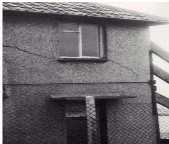
Figura 8 – Fissura por recalque de fundações. Fonte: ELDRIDGE (1982).
