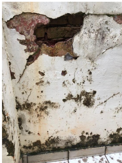
Figura 35 – Foto tirada em inspeção.
