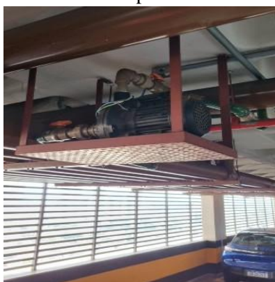
Figura 09 – bomba utilizada para levar água até o 15º pavimento
