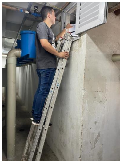
Figura 10 – levantamento da vazão do sistema de ar-condicionado
