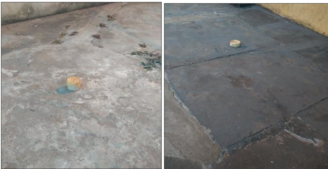
Figura 8 e 9: Fossas nas calçadas das residências do município de Indiara
