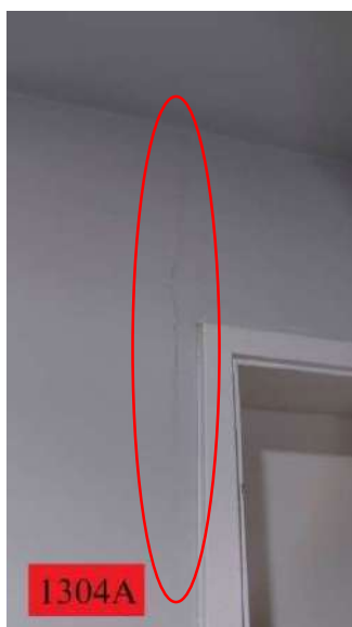
Figura 13 – Manifestação de fissura/trinca na Torre 1, no Apartamento 1304, Dos autores (2022).
