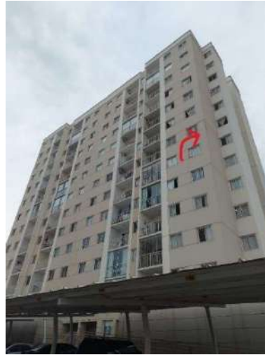
Figura 57 – Identificação de trincas na Torre 2, Dos autores (2022).
