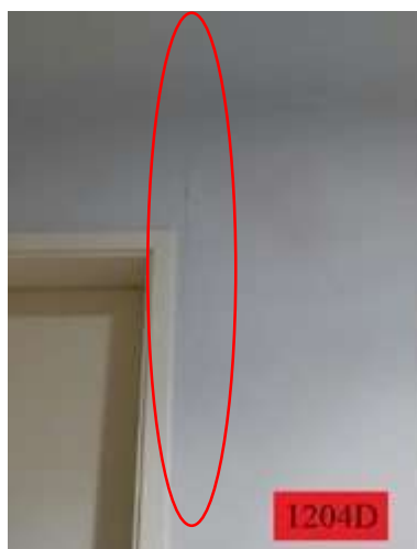
Figura 24 – Manifestação de fissura/trinca na Torre 2, no Apartamento 1204D, Dos autores (2022).
