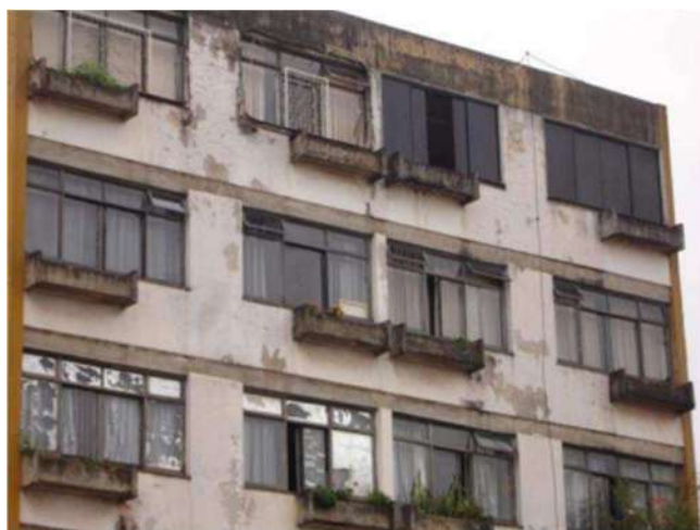
Figura 9 – Bolor sobre a fachada de um edifício, Antunes (2010) [2].
