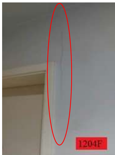
Figura 35 – Manifestação de fissura/trinca na Torre 3, Apartamento 1204F, Dos autores (2022).
