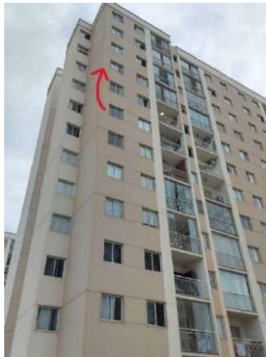
Figura 46 – Trincas calafetadas na Torre 1, Dos autores (2022).
