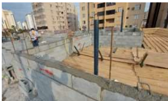
Figura 3 – Graute aplicado nas canaletas e furos da alvenaria na obra Wish Aeroporto em Goiânia/GO, Dos autores (2022).
