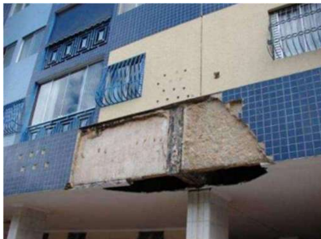
Figura 8 – Deslocamento localizado do emboço (Laboratório de Ensaio de Materiais – UnB), Antunes, (2010) [4].
