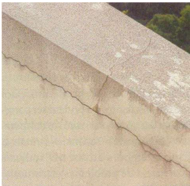
Figura 11 – Fissuras por movimentação térmica, Corsini (2010)[16].
