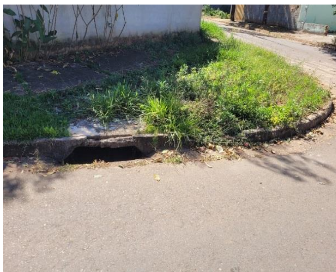
Figura 5 – Boca de lobo Rua JC- 43, Autor (2023).
