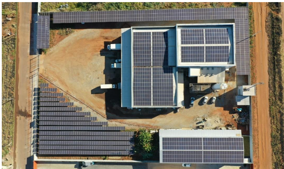
Figura 5 – Imagem das placas fotovoltaicas do Gelo Mineral Fonte: Gelo Mineral, 2023
