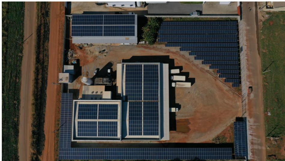
Figura 4 – Imagem das placas fotovoltaicas do Gelo Mineral Fonte: Gelo Mineral, 2023
