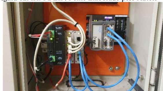
Figura 13. CLP NEXTO na rede da subestação. Fonte Elaborado pelo Autor.
