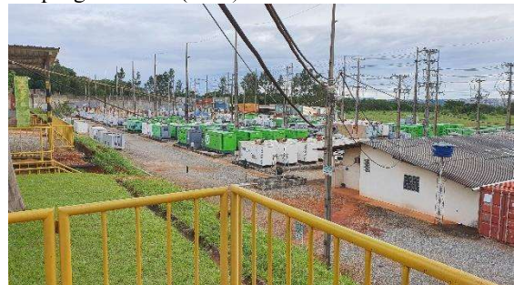
Figura 6. Setor de Geração da subestação. Fonte Elaborado pelo Autor.
