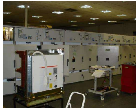
Figura 3. Celas de Média Tensão. Fonte (Caldas, 2015).
