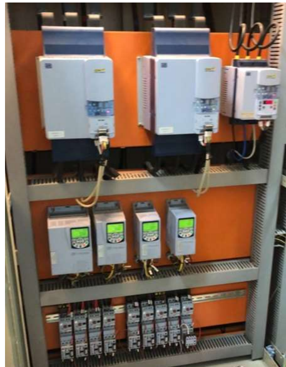
Figura 04: Inversor de Frequência e Soft-Starters.
