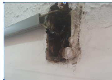
Figura 2 - Derivação de circuito exposta
