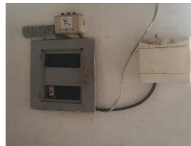
Figura 1 - Quadro geral de baixa tensão
