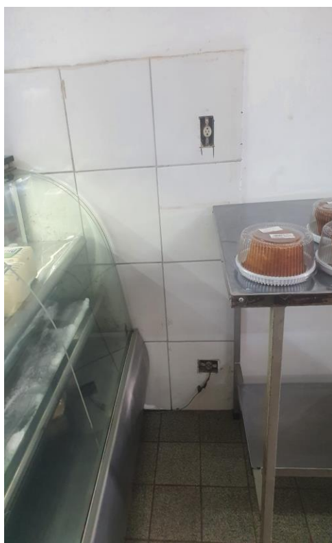
Figura 4 - Tomadas sem a devida fixação
