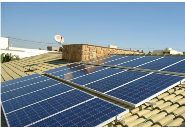
Fig. 5. Sistema fotovoltaico residencial on-grid [10].
