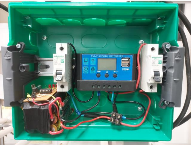
Figura 25 – Painel do controlador de carga
