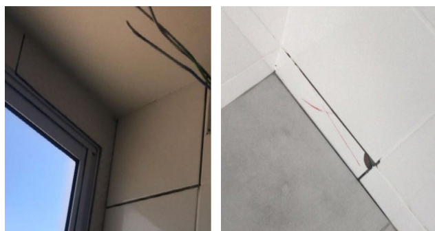
Figuras 10 e 11 - Manifestações patológicas incidentes nos revestimentos cerâmicos do empreendimento A
