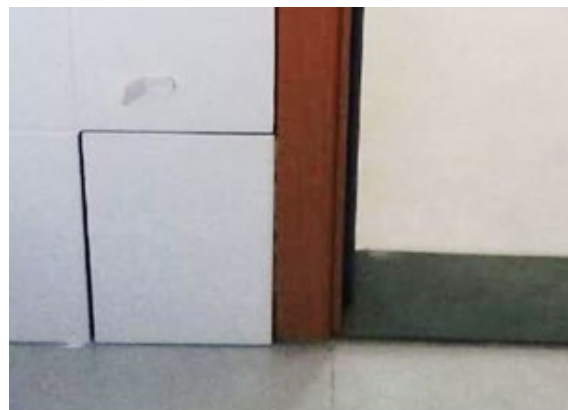
Figura 16 - Falta rejunte encontrados nas vistorias no empreendimento B
