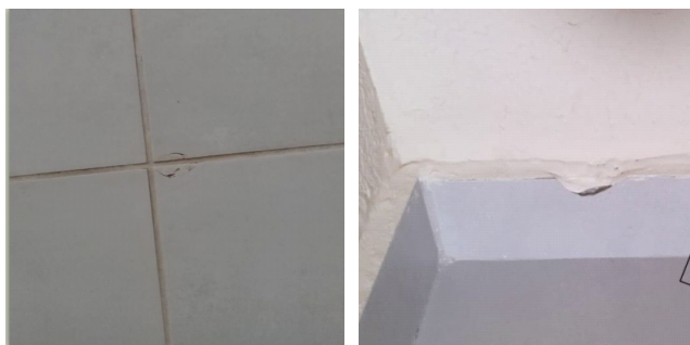
Figuras 13 e 14 - Manifestações patológicas incidentes nos revestimentos cerâmicos do empreendimento B
