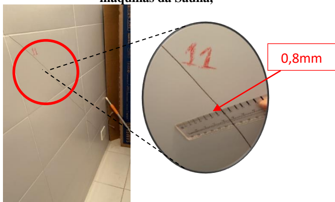
Figura 26- Localização da trinca do ID 11, na sala de máquinas da Sauna,
