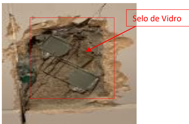
Figura 30- Acompanhamento da ID 10, no revestimento cerâmico, através do método do selo de vidro.
