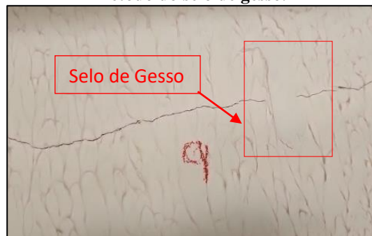
Figura 19- Acompanhamento da ID 09, na alvenaria entre a garagem e sala da administração, através do método do selo de gesso.
