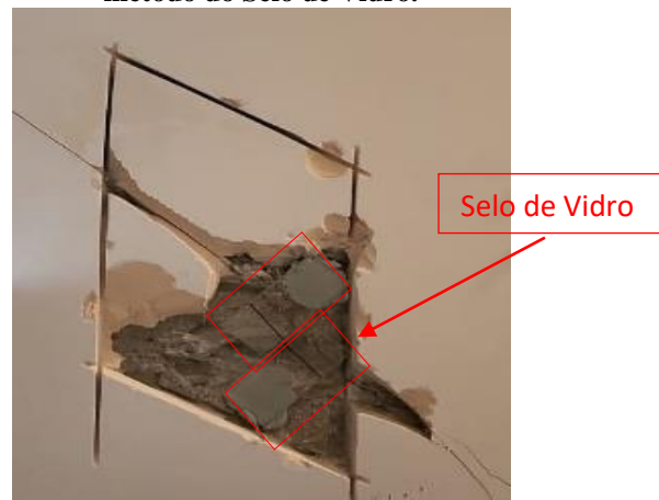
Figura 27- Acompanhamento da ID 28, revestimento cerâmico deslocado com fissuração, através do método do Selo de Vidro.
