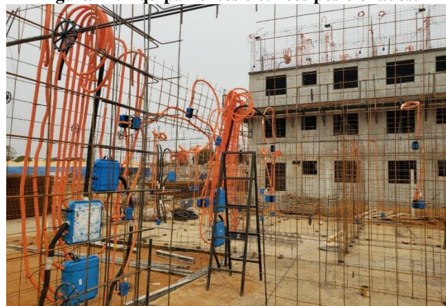
Figura 11: Equipamentos elétricos posicionados.
