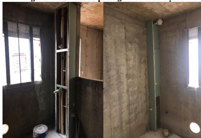
Figura 14: Shafts de passagem de tubulação.
