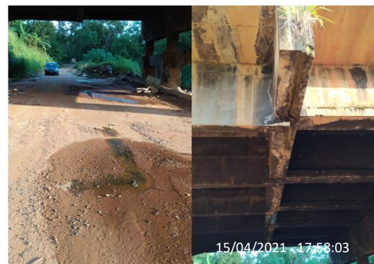
Figura 05- Junta de dilatação com infiltração, deslocamento do concreto e armadura exposta.
