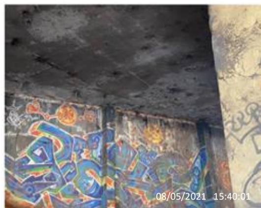
Figura 10- Manchas de lixiviação.
