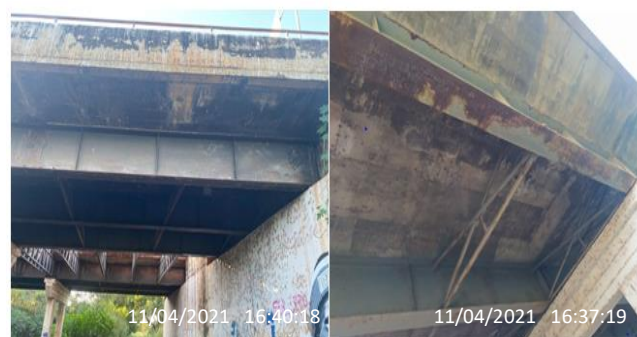
Figura 08- Manchas de insalubridade e viga metálica com oxidação.
