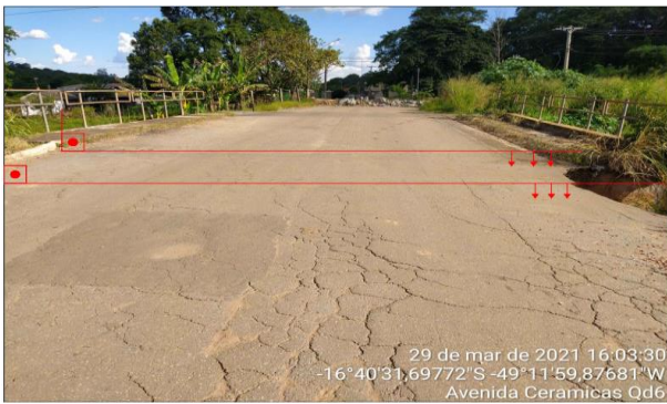
Figura 02 - Recalque da pista.
