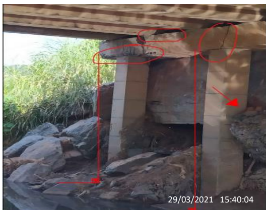
Figura 04- Pilares inclinados, gabiões mal encaixados e rachaduras na travessia direta, ausência de aparelhos de apoio.
