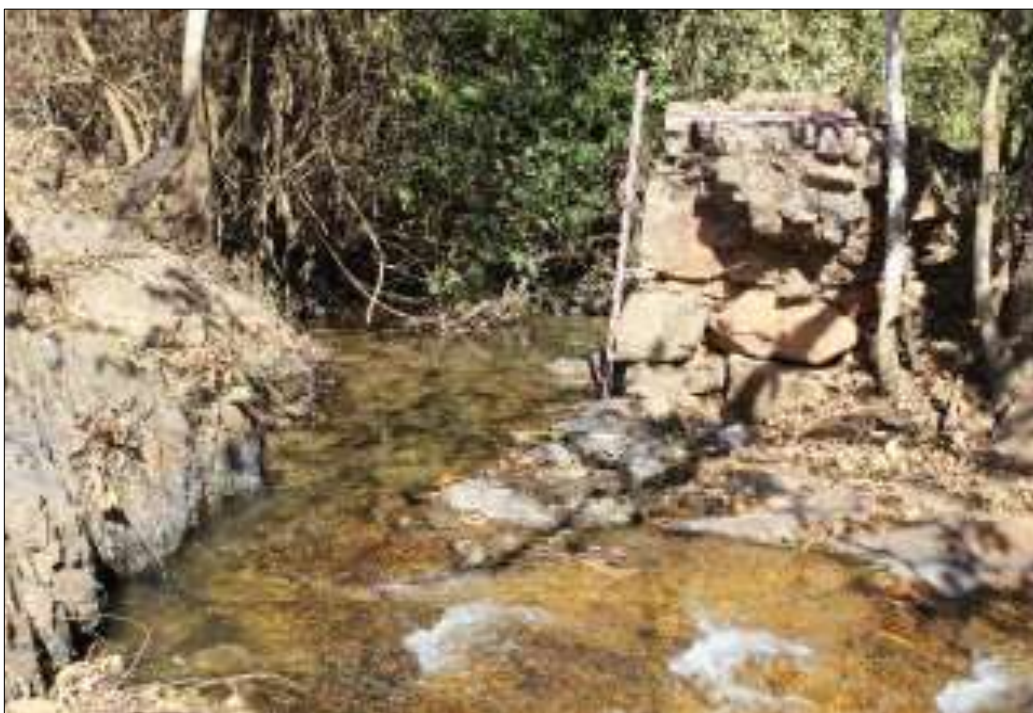
Figura 34: Sítio Facão II, área 3 - Usina Facão. Perfil do muro de contenção da Barragem. Fonte: A LASCA, 2020, p.120.
