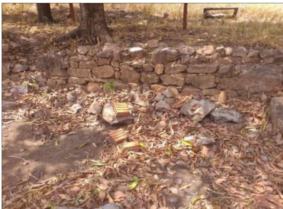
Figura 31: Sítio Facão II, área 2 - Escola e Capela. Muro de arrimo parcialmente colapsado. A LASCA, 2020.
