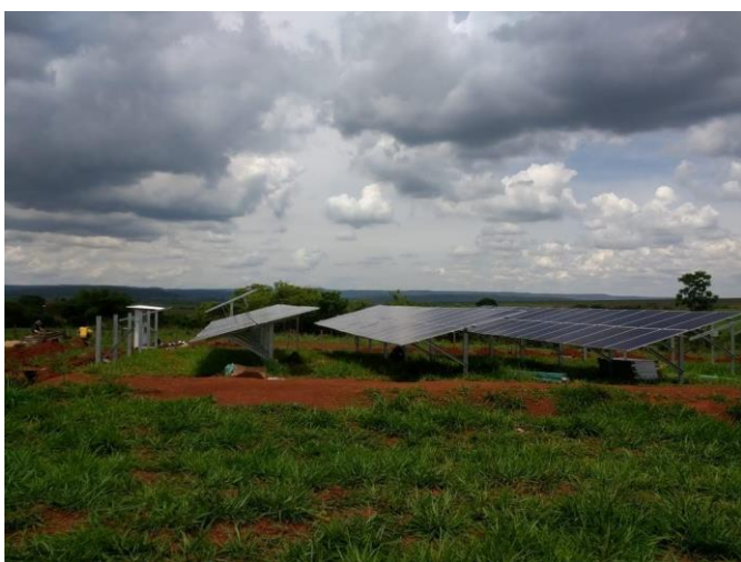
Fig. 9: Módulos fotovoltaicos instalados
