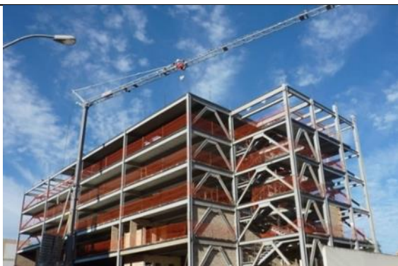
(b) Vista do arranjo do sistema de contraventamento. Fonte: Acervo dos autores.
