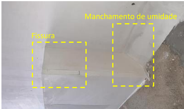
Figura 4 – Anomalias encontradas no gesso corrido.
