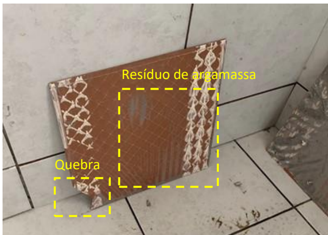
Figura 7 – Peça de revestimento cerâmico que sofreu deslocamento ainda com resíduo de argamassa e quebra no canto inferior esquerdo. Argamassa aplicada apenas no substrato.
