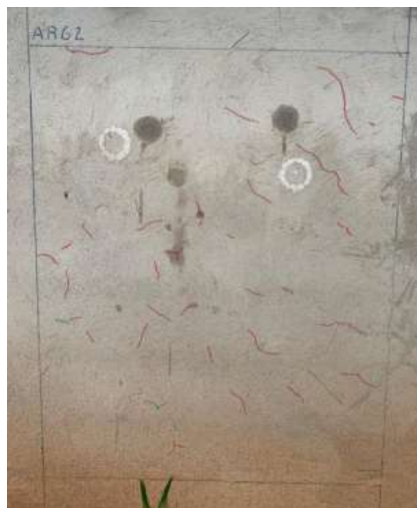
Figura 11 – Análise de formação fissuras (ARGII)
