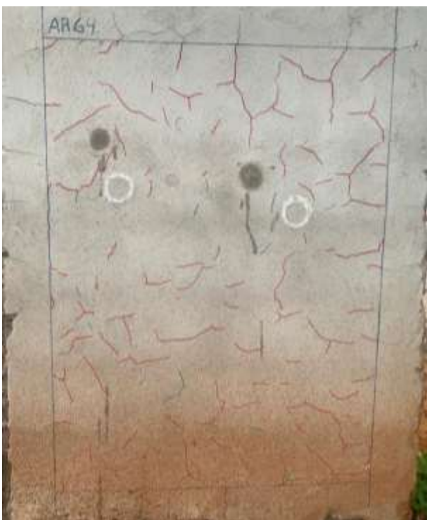
Figura 13 – Análise de formação de fissuras (ARGIV)
