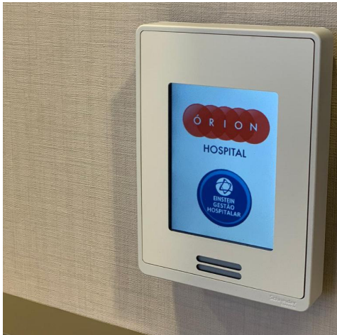
Figura 17. Termostato fixo de Controle do Ar-Condicionado dos leitos.
