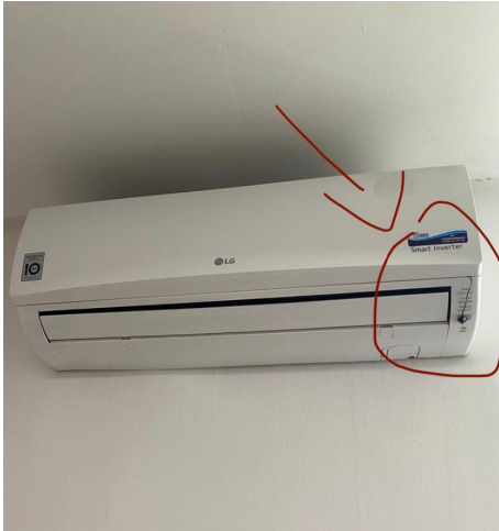
Figura 16. Emissor IR ligado ao aparelho de Ar-Condicionado.
