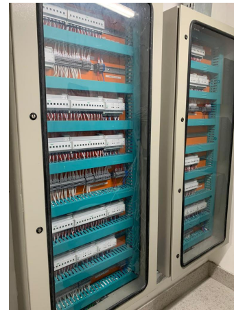
Figura 15. Quadros de automação.
