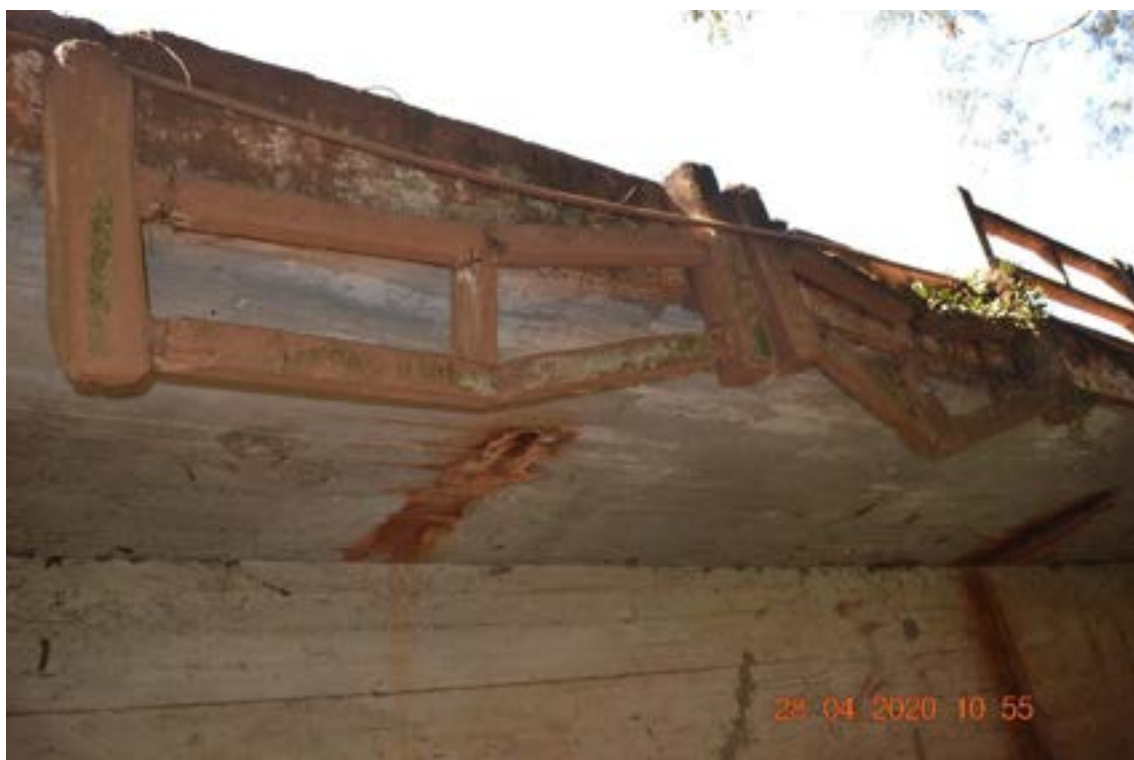
Identificação: Fotografia 9 – Guarda-corpo rompido pendurado no tabuleiro.
