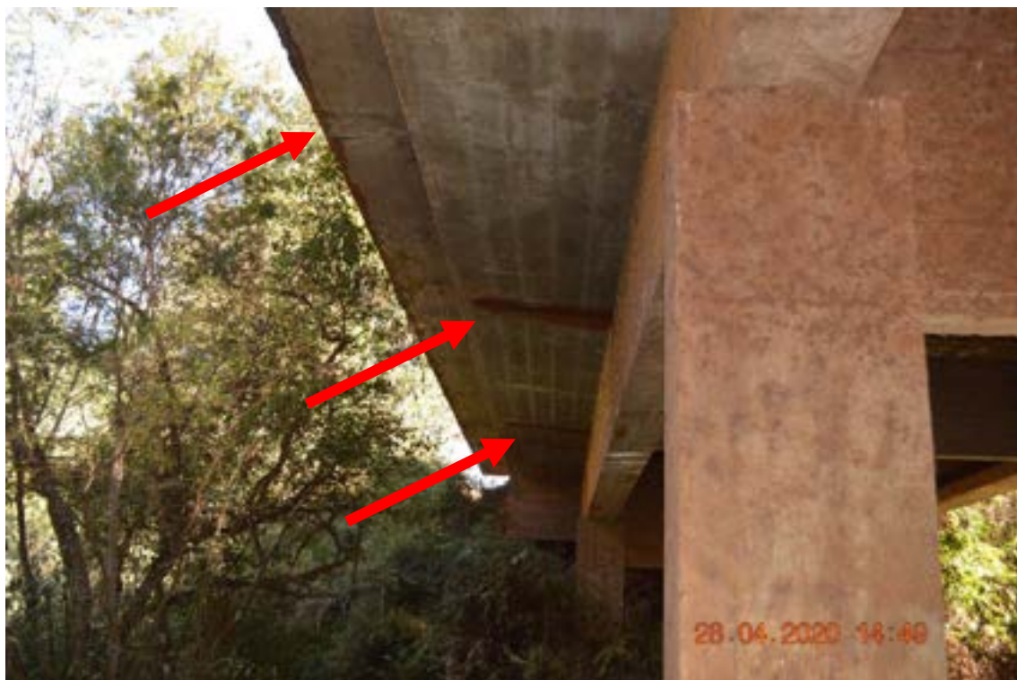
Identificação: Fotografia 9 – Lixiviação devido a ausência de pingadeira com exposição de armadura e corrosão superficial sem perda de seção transversal das barras de aço.
