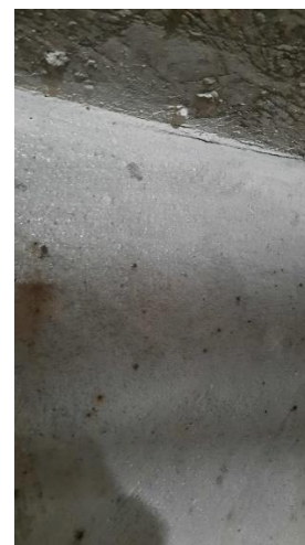
Figura 24 - Escorrimento de água na casa de bomba no subsolo.
