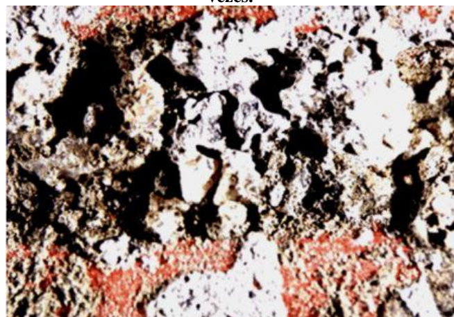
Figura 2 - Vista geral da amostra de bloco cerâmico chapiscado após a fratura do revestimento. Imagem obtida na lupa estereoscópica com ampliação de 51,2 vezes.
