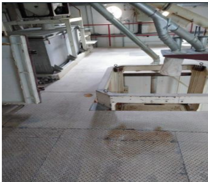
Figura 22 – Segundo andar da fábrica – maquinário
