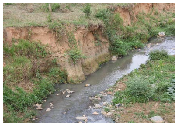
d) P6: retirada no local da desembocadura do córrego, apresenta um processo erosivo por solapamento.
