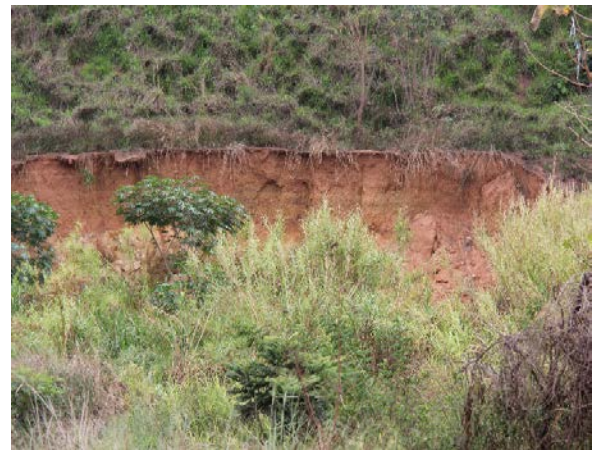
b) P3: Processo erosivo na Av. Acary Passos, erosão por ravinamento.
