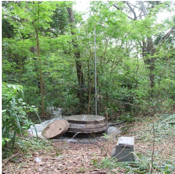
a) P2: presença da mata de galeria, e caixa de esgoto transbordando em céu aberto.
