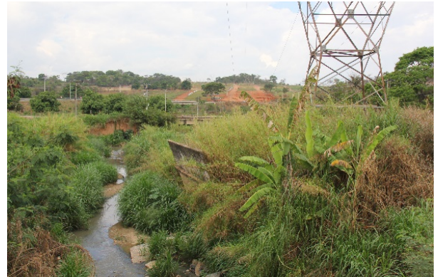
b) P5: apresenta placa de contenção danificada, e a linha de transmissão.
