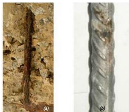
Figura 1 – Corrosão desencadeada pela carbonatação do concreto (a) e corrosão desencadeada pela ação dos íons cloreto (b).
