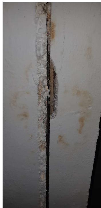
Figura 2 – Infiltração na junta de dilatação
