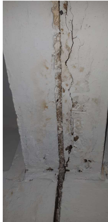
Figura 7 – Infiltração e armadura exposta na junta de dilatação
