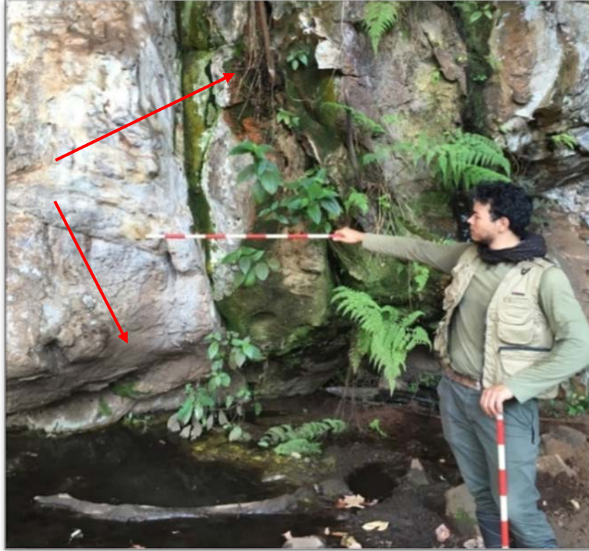
Figura 28 Depósito de água resultado da percolação de água entre as fraturas, além de raízes nos planos de fraturas. Foto: Acervo Projeto Serranópolis.
