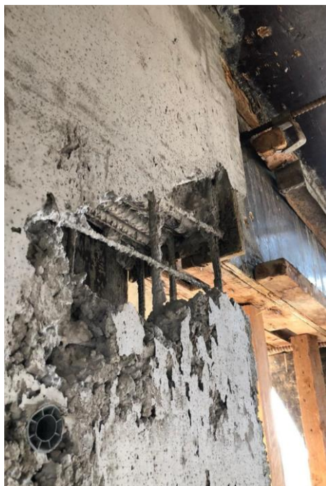
Figura 15. Representação de um pilar com ninho de concretagem
