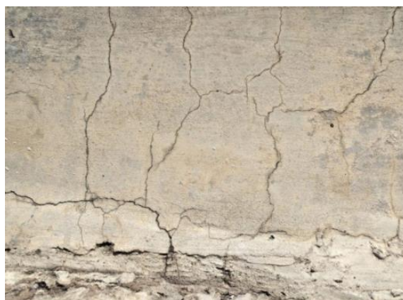
Figura 6. Representação de fissura generalizada no reboco
