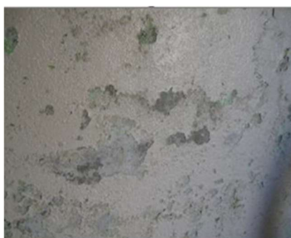
Figura 1: Umidade por infiltração. Fonte: Duarte, Lage e Aguiar (2012)
