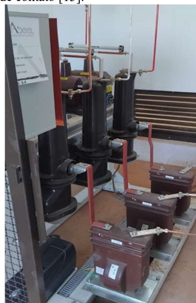
Figura 9. Transformador de Corrente para leitura do Relé. Fonte: Foto do autor (2026).
