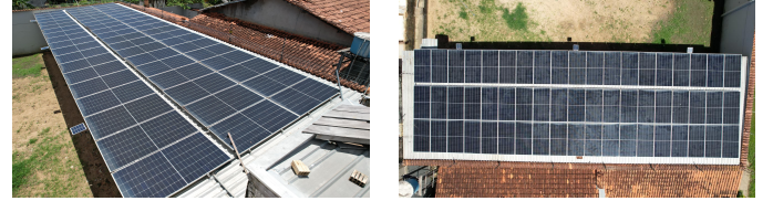
Figura 3. Módulos fotovoltaicos da instalação L. A. Amaral, antes (esquerda) e depois (direita) da execução da limpeza. Fonte: Autoria própria.
