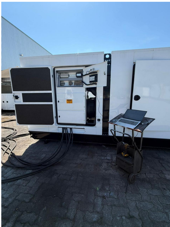
Fig. 8. Fotografia da etapa de coleta de dados na unidade geradora diesel.
