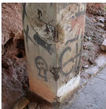
Figura 9: Corrosão das armaduras [9].
