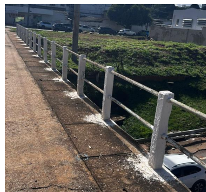
Figura 20: Guarda-corpo com altura insuficiente [Autores].
