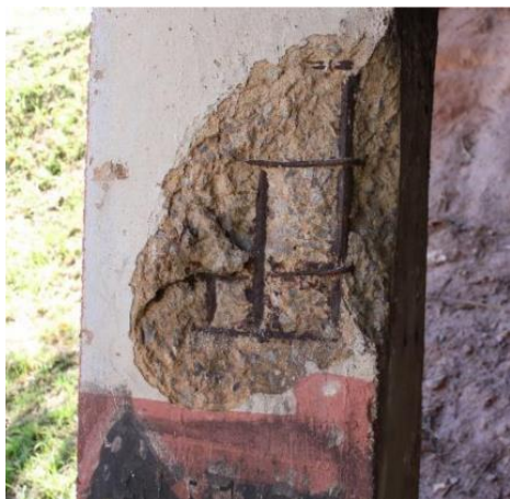
Figura 7: Corrosão das armaduras [9].
