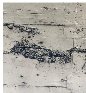
Figura 14: Segregação de concreto [Autores].
