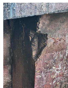
Figura 6: Armadura exposta em pilar [Autores].
