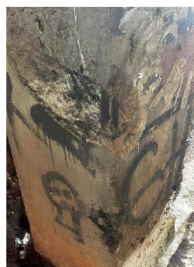
Figura 10: Corrosão das armaduras [Autores].
