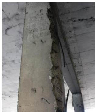
Figura 3: Armadura exposta em pilar [9].
