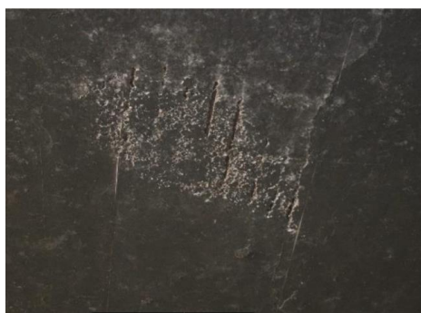
Figura 11: Segregação de concreto [9].
