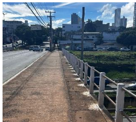
Figura 18: Falta de barreira rígida [Autores].
