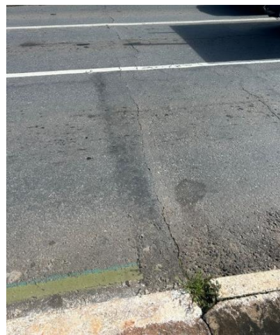
Figura 16: Fissuras no revestimento asfáltico [Autores].
