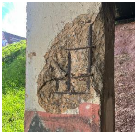
Figura 8: Corrosão das armaduras [Autores].
