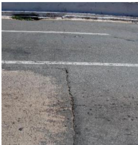
Figura 15: Fissuras no revestimento asfáltico [9].
