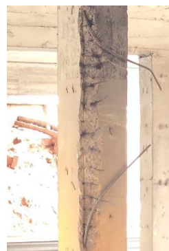
Figura 4: Armadura exposta em pilar [Autores].
