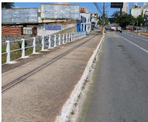
Figura 17: Falta de barreira rígida [9].
