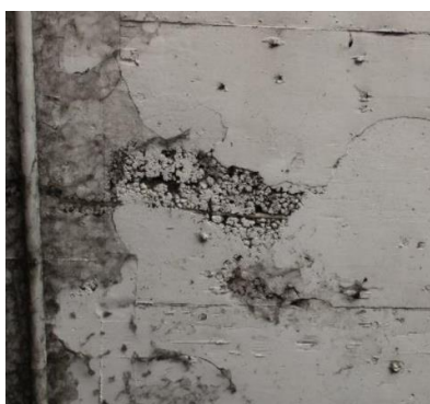
Figura 13: Segregação de concreto [9].
