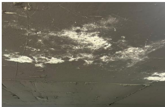
Figura 22 – Lixiviação no tabuleiro da ponte [Autores].
