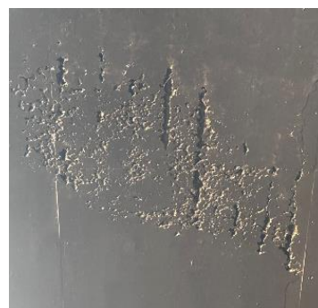
Figura 12: Segregação de concreto [Autores].
