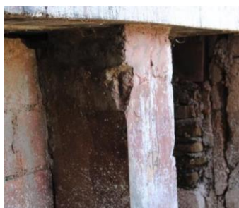
Figura 5: Armadura exposta em pilar [9].
