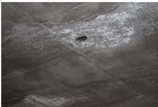
Figura 21 – Lixiviação no tabuleiro da ponte [9].
