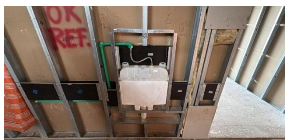
Figura 12 – Instalações hidráulicas Fonte: Própria
