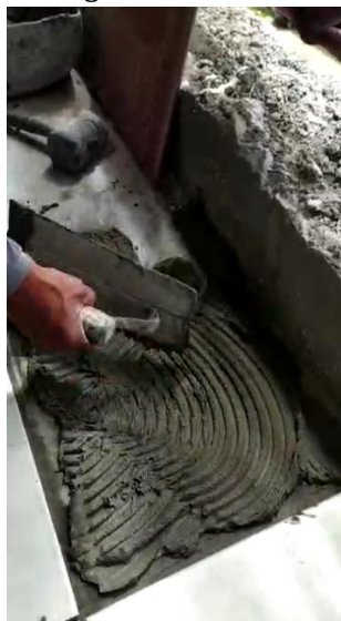
(a) Sulcos mal executados
