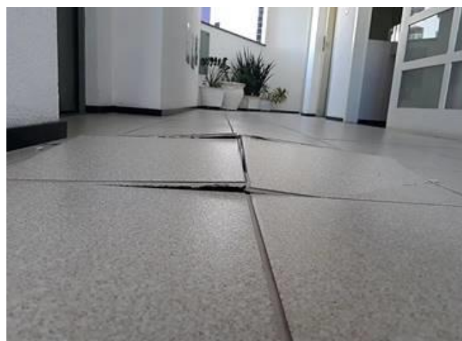
Figura 2 – Aspecto do piso afetado pelo descolamento de placa cerâmica.
